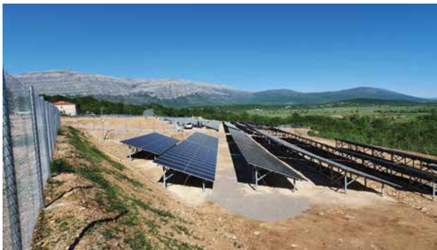
Pogled na fotonaponske panele sa zapadne strane
