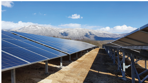
Pogled na fotonaponske panele
