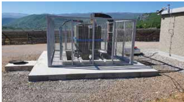
Pogled na trafostanicu
